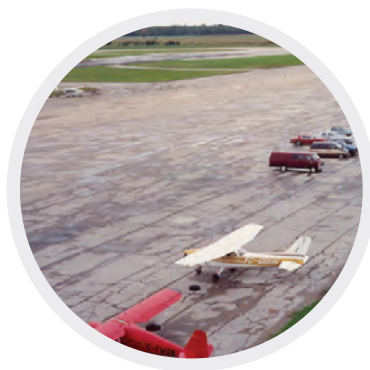
Situation vor Reparatur der Asphaltfläche 1992 - kritischer Zustand
